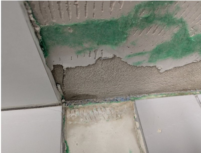
Abb.: nasse Wände unter nicht funktionierender Abdichtung
