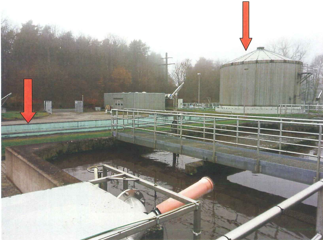
Abbildung 3.3: KA Büchen Belebung (DN), ZKB mit TK (außer Betrieb)
