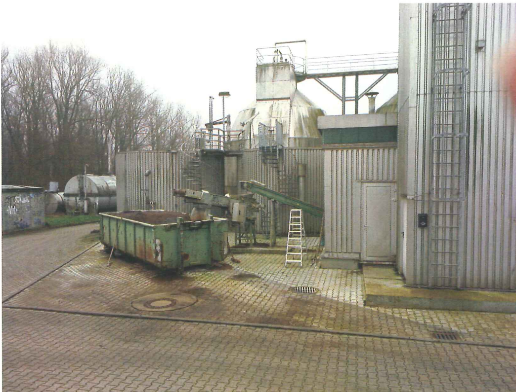
Abbildung 3.5: KA Büchen Faulbehälter, Vorlagebehälter, Schlammcontainer
