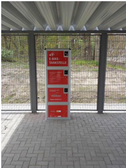
Abb. 10: E-Bike-Ladestellenschrank am Bahnhof Klinikum Bremen-Nord/Beckedorf
