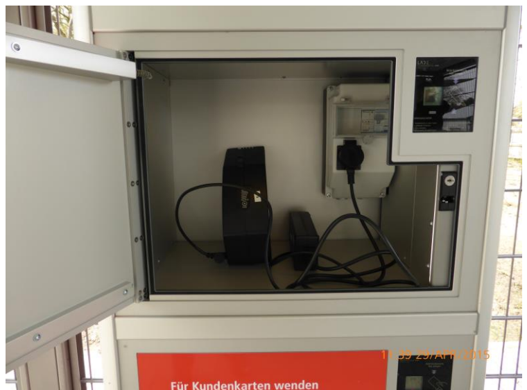
Abb. 11: Blick in ein Schließfach mit angeschlossenen Akku
